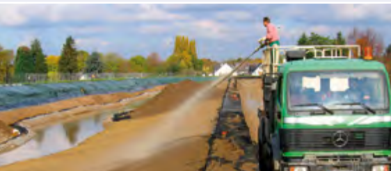
Moderne Anspritzbegrünung. Heute ist man weiter. Ein Arbeitsgang reicht. Dünger, Kleber und Saatgut werden zusammen aufgebracht, hier bei der Emscher-Renaturierung .
